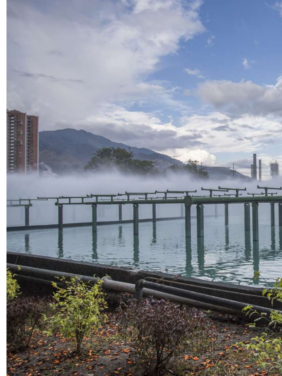
Sistema de refrigeración por aspersión Fabricato.
